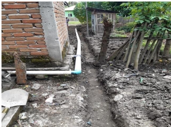
Gambar 3 Pipa penyaluran air limbah Rumah Tangga dari tempat pencucian dan kamar mandi.
